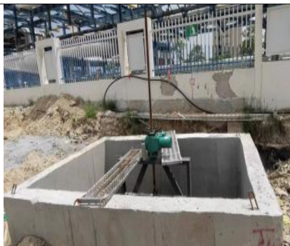
雨水应急切换阀门
